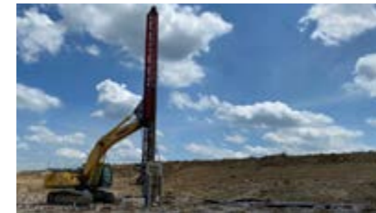
Turnstile Data Center (USA)
