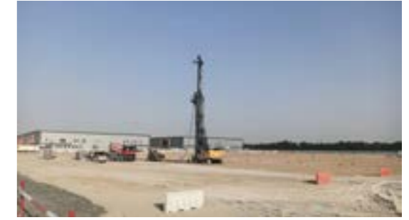
Khazna Data Center (UAE)
