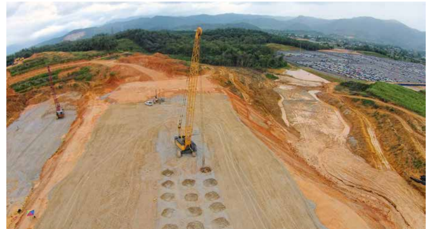
▲ Malaysia - Serendah UMW, Selangor
